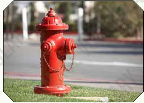
Fire Hydrant (ফায়ার হাইড্রেন্ট) রাস্তার ধারে পানির কল
